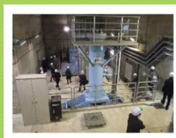
④利水・緊急放流ゲート室
