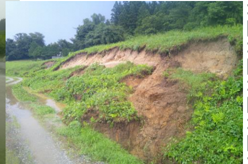
市道梨ノ木線 のり面崩落による水路閉塞
