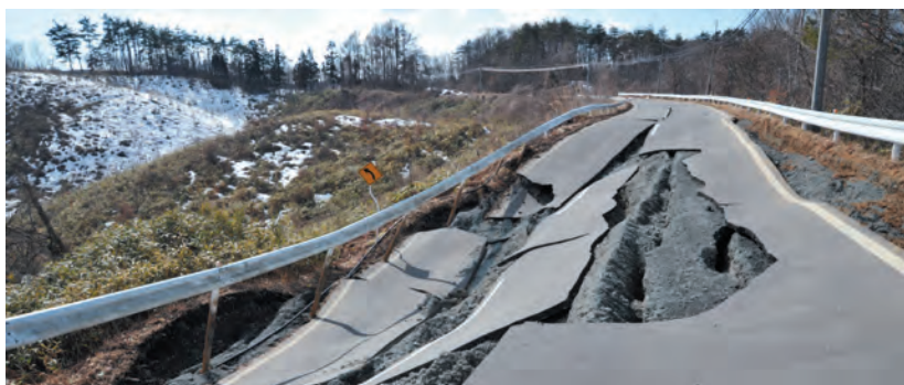
地震によって大きく崩れた道路 (江刺区広瀬)
