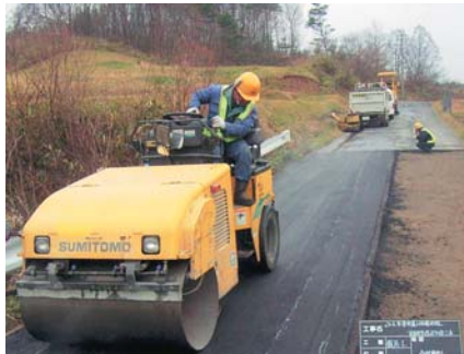
災害でひび割れた道路も復旧
