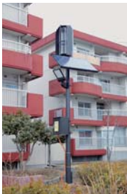
石田住宅に整備された照明灯
