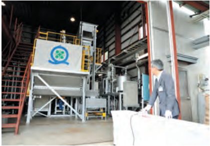
黒滝温泉のガス化発電施設
