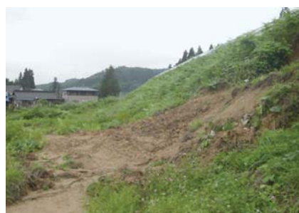
昨年7月に発生した江刺区外ノ沢智福線斜面の崩落
