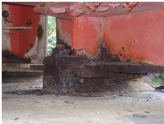
支承部の劣化
