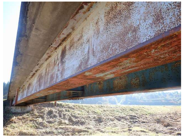
鋼部材の劣化
