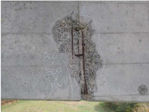
コンクリート部材の断面欠損
