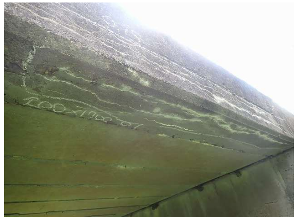
コンクリート部材のひびわれ
