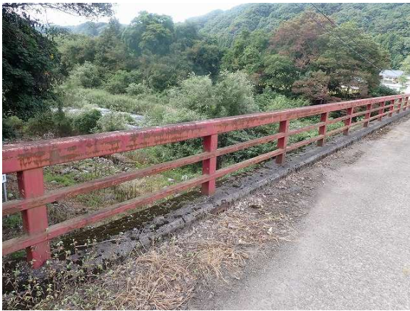
防護柵の劣化
