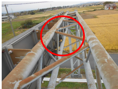
防食機能の劣化
