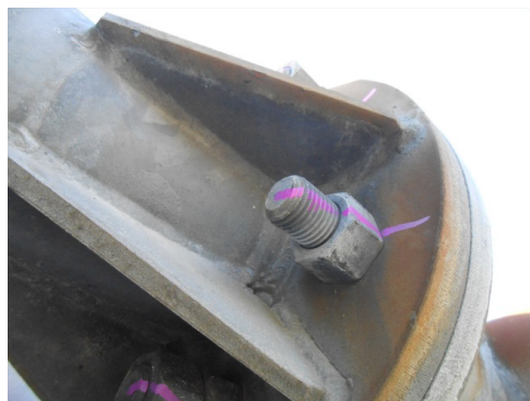
ボルトの脱落
