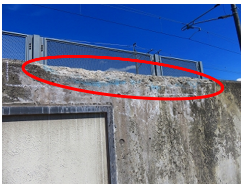
コンクリートの欠損
