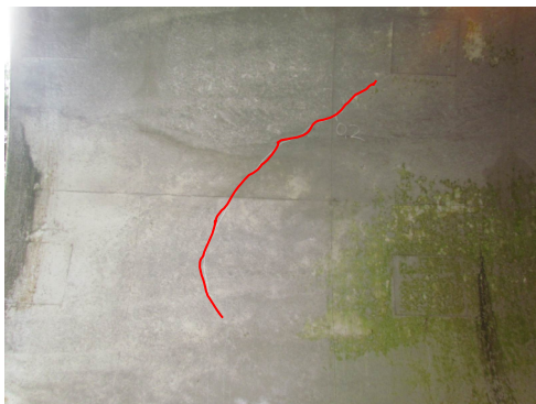
コンクリートのひび割れ
