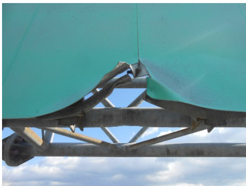
標識板の損傷
