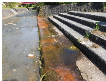
【湧水の状況】 盛土法面や擁壁からの湧水や湿り気等の痕跡が確認されないか
