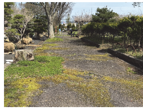
▲ 根上がりによるアスファルトの隆起箇所
