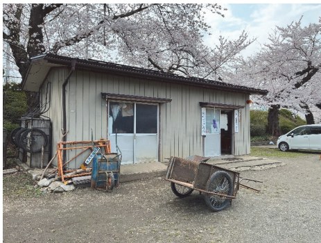
▲ 老朽化した管理人詰所兼倉庫
