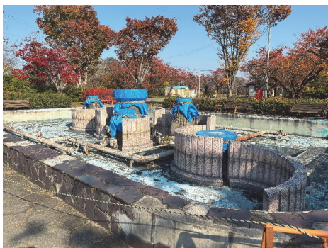
▲ 故障中の噴水施設
