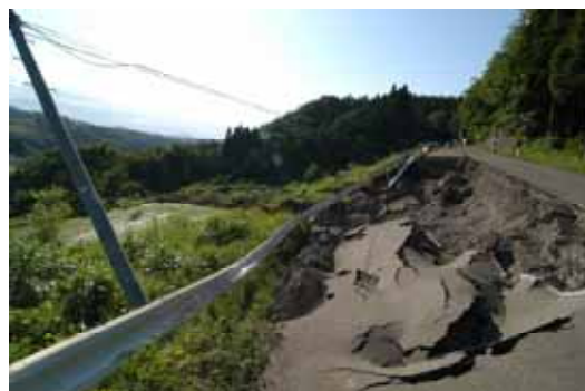
岩手・宮城内陸地震で崩れた道路
