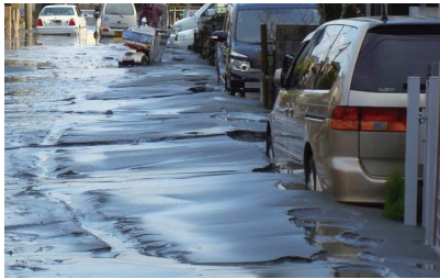
液状化で砂がふき出した例
