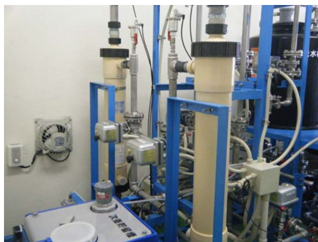
横岳前山浄水場膜モジュール
