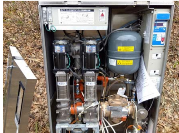
ユニットポンプ内部
