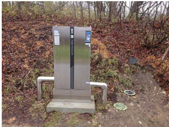
羽田高区加圧ポンプ場（全景）
