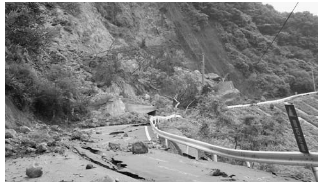
現在も通行止の県道花巻衣川線
