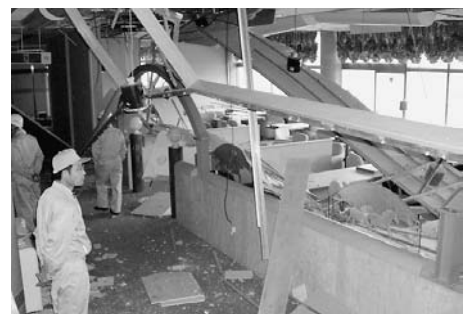
水沢競馬場テトラック3階部分の被害
