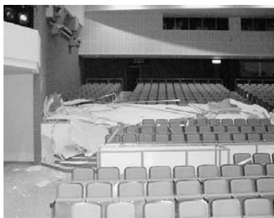
胆沢文化創造センターの天井崩落
