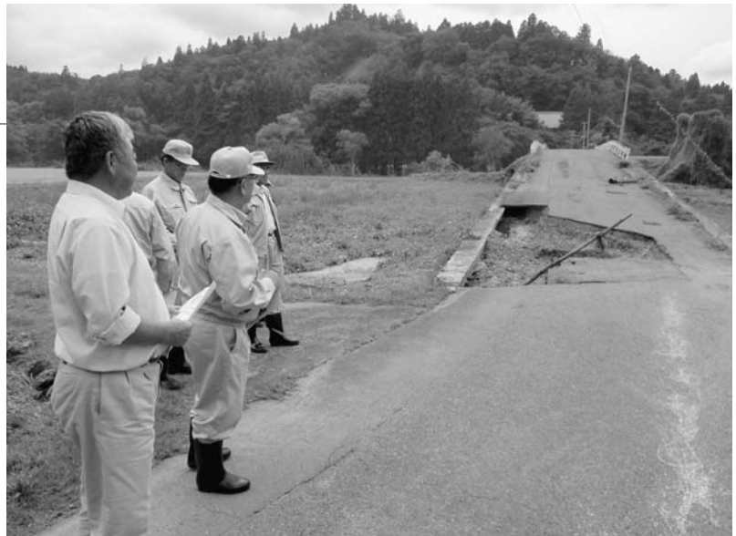
9月10日大雨洪水警報発表に伴う災害（建設環境常任委員会による調査）
