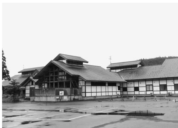
急がれる国見平温泉の屋根改修
