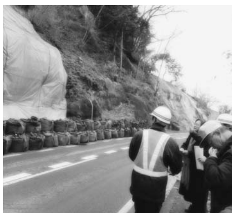
2017年11月江刺地区内のがけ崩れ現場
