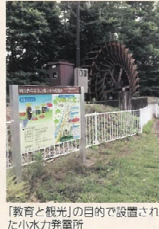
「教育と観光」の目的で設置された小水力発電所
