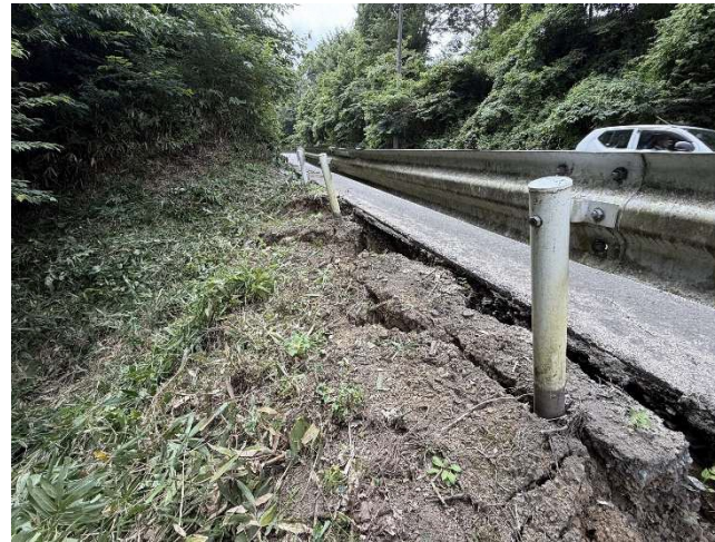
路肩法面崩落
