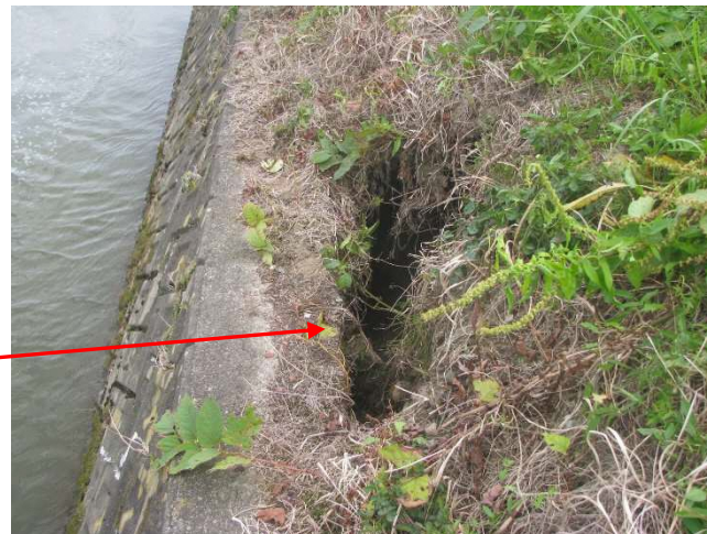
ブロック積工裏洗堀
