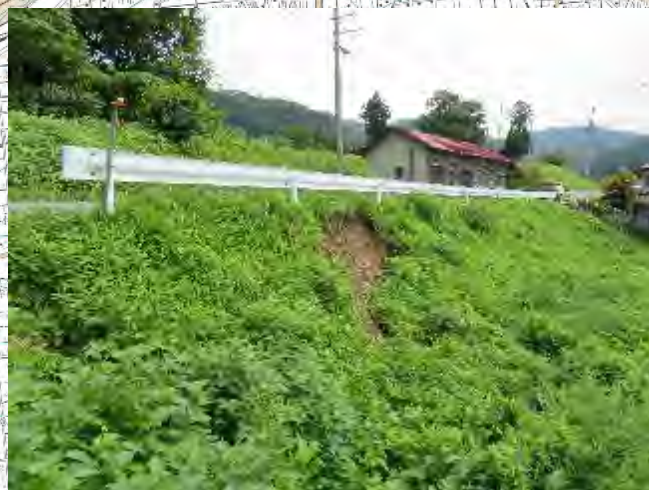
NO. 38 地ノ神久保線 法面崩落
