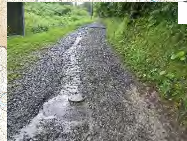
NO. 1 高梨線 路面洗堀
