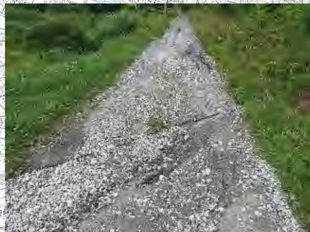
NO. 16 人首街道線 路面洗堀
