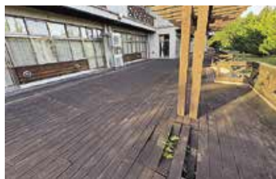
修繕が必要な旧伊手小学校のウッドデッキ
