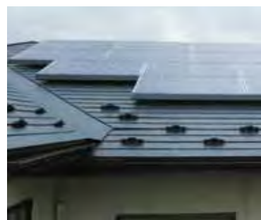
設置された太陽光発電システム
